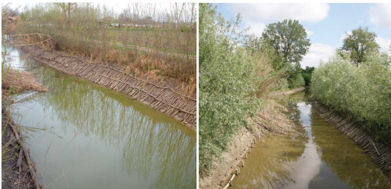
Fig. 7-8 – Copertura diffusa con astoni di salice: Canale di Migliarina durante i lavori e dopo 5 anni (Fonte: Linee Guida Riqualificazione Canali, Regione Emilia Romagna)
