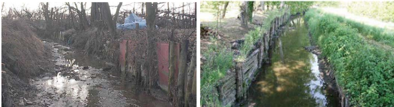
Fig. 7-8 – Palizzata rinverdita: Canale di San Pietro prima dei lavori e dopo 5 anni dalla realizzazione della palificata viva (Fonte: Linee Guida Riqualificazione Canali, Regione Emilia Romagna)
